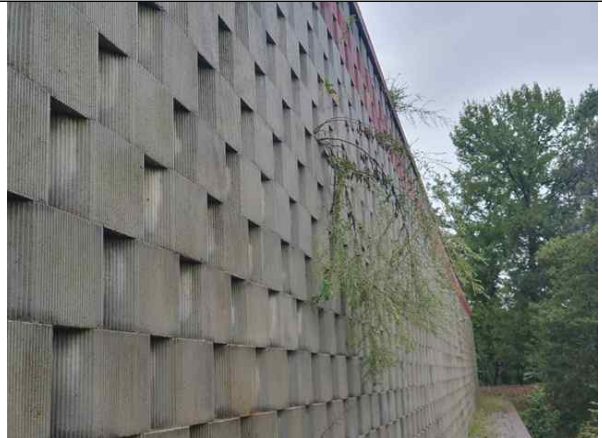
손상내용 옹벽 2단 전면 벽체 식생
