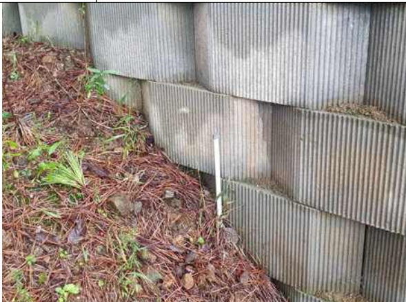
손상내용 옹벽 1단 전면 블록 균열
